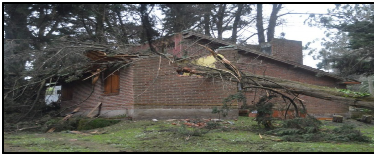
Imagen 6. Caída de un árbol sobre una vivienda luego de un temporal
