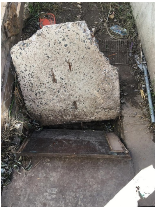
Figura 4. Cámaras de desagües cloacales rotas en el barrio.
