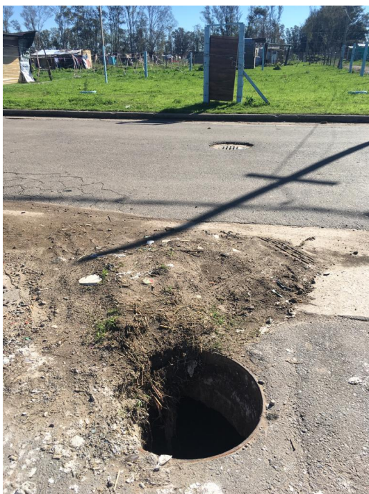
Figura 3. Infraestructuras hídricas sin mantenimiento en el barrio
